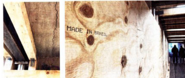
Hier (linkes Bild) ein Blick auf die Decke des Fußgängertunnels. Rechts: Die Paneele stammen von einem der großen brasilianischen Holzverarbeiter. Es soll sich um zertifiziertes Plantagenholz handeln.
